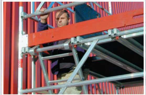
Der sichere Innenaufstieg
